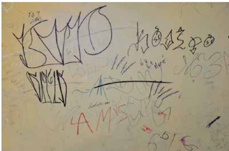
Figura 3 Sala de aula. Pichações sobre parede. Foto: Paul Moraes 2011.
